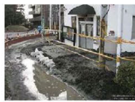
地盤沈下により傾いた交番
