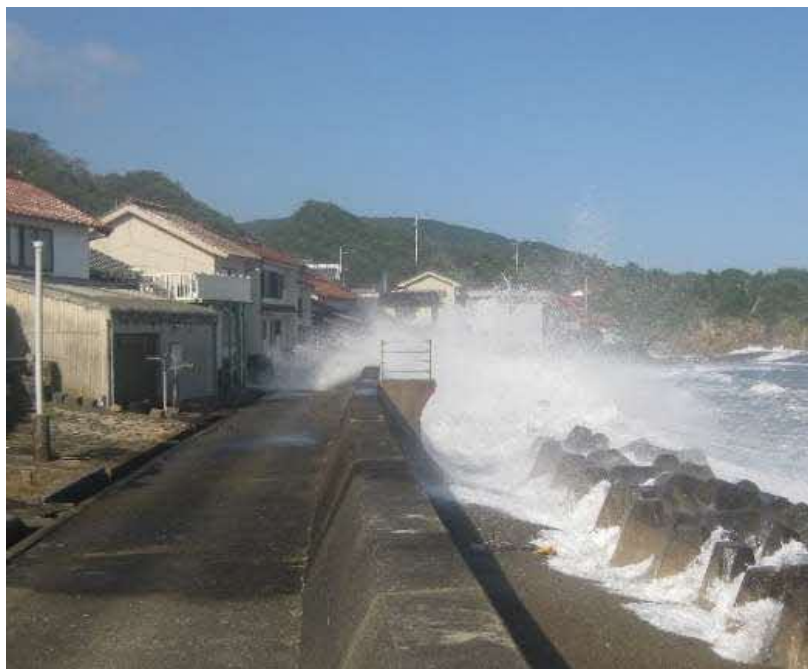
【 小浜海岸における越波の状況 】
