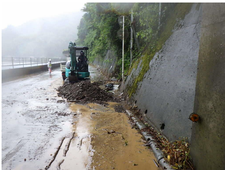
【一般国道9号の事前通行規制区間（土砂流出状況）】
