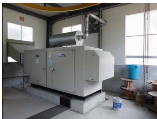
図 5.8 非常用自家発電設備
