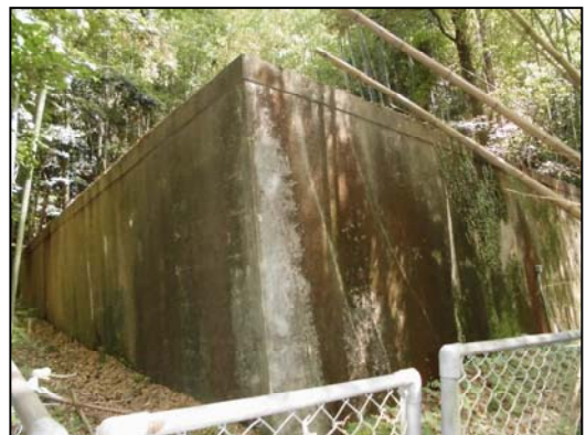
図 3.6 老朽化した施設
