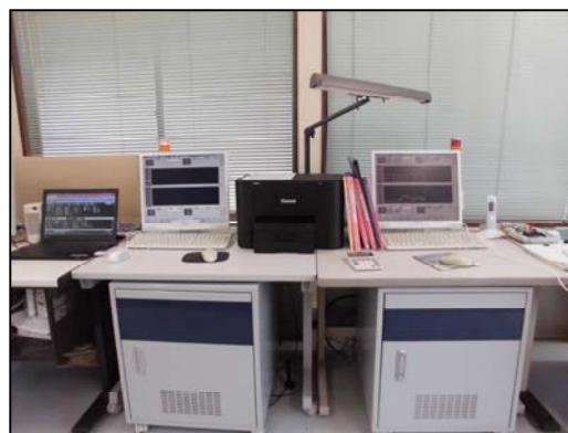
図 5.11 集中監視設備
