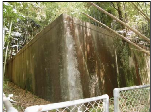
図 3.6 老朽化した施設
