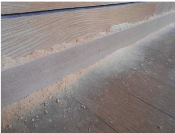
食害壁の下部
