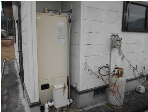
電気温水器・ガス
