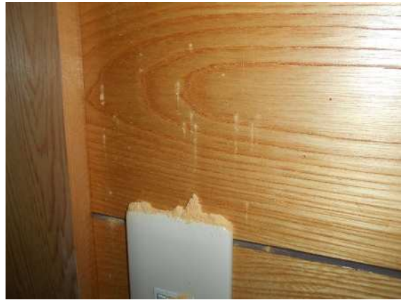
壁の食害（穴から粉状の物が出ている）
