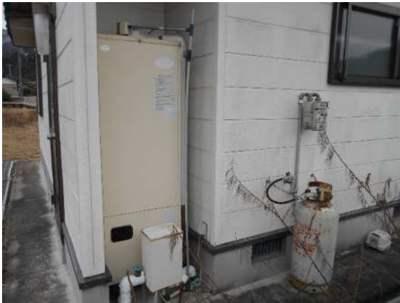
ボイラー・ガス・プロア
