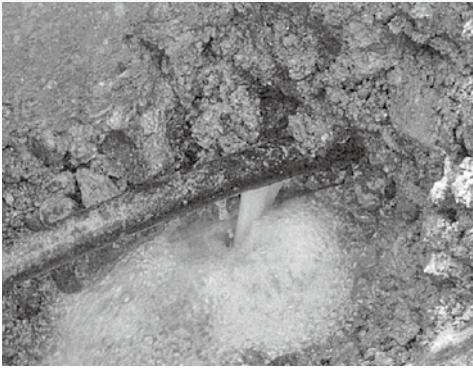
漏水している水道管
